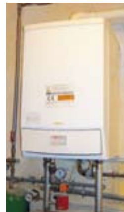
Caldaia palazzo comunale
